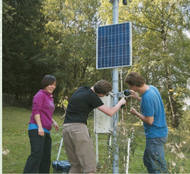
Aufbau einer meteorologischen Station
